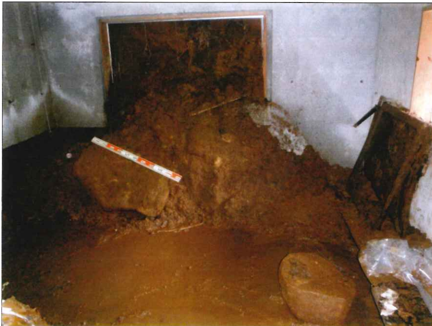
土工 崩土転石状況 地下室
