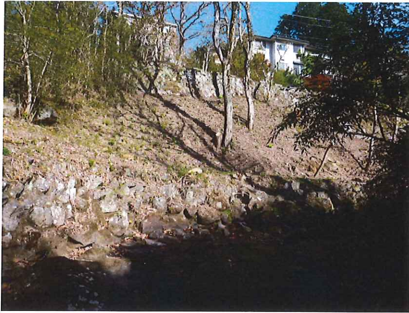
坂下バス停付近水路補修 、草刈、樹木整備完了 水路内東に向い撮影
