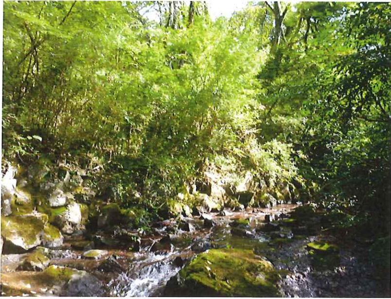
坂下バス停付近水路補修、草刈、樹木整備施行前 水路内東に向い撮影
