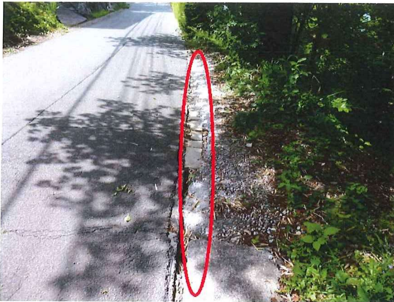
ゴミステーションNo.28 砕石仕上げ の箇所が雨により道路に流出 砕石撤去前
